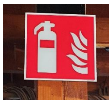
Boven de plek waar een blusser hangt, is een duidelijk zichtbaar bordje met aanduiding.
